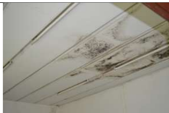
Figura 26 – Forros danificados pela existência de patologias na cobertura.
