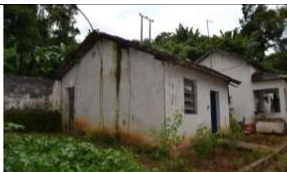
Figura 07 – Marcas que denunciam a presença de cupim de solo.
