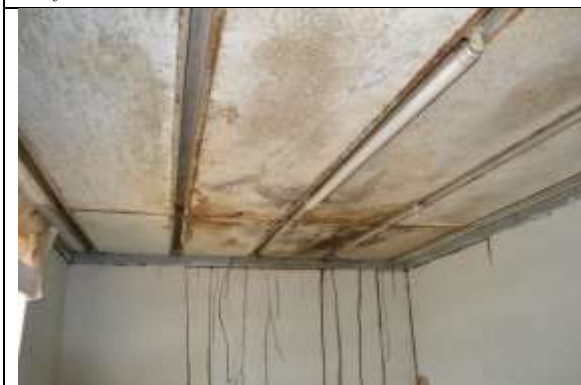
Figura 08 – Marcas que denunciam a presença de cupim de solo. Forro comprometido pela umidade e cupins.
