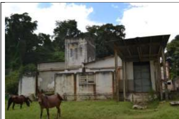
Figura 37 – Casa de força e construção adjacente, em aspecto de ruína.
