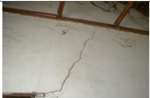
Figura 23 – Trincas nas alvenarias.
