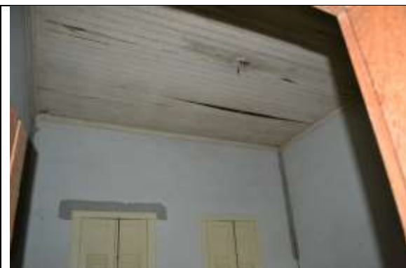
Figura 33 – Comprometimento do forro.
