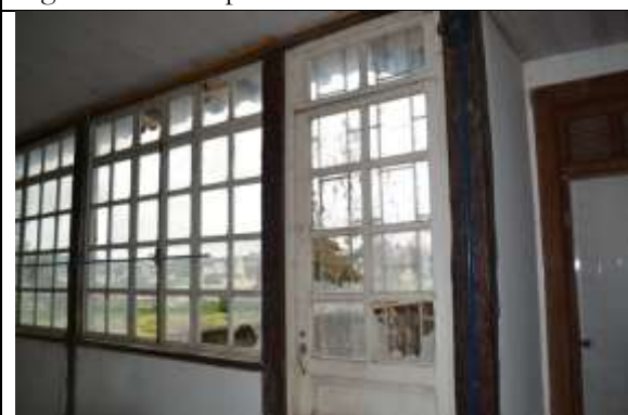
Figura 35 – Esquadrias com vidros quebrados.
