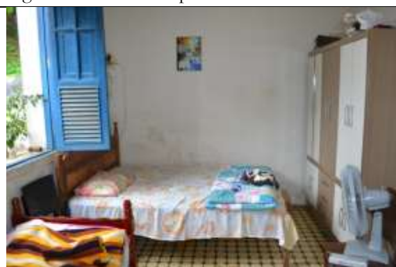
Figura 13 – Manchas de umidade na parede.
