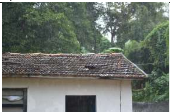
Figura 09 – Danos na cobertura.
