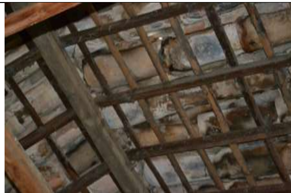
Figura 22 – Danos na cobertura.
