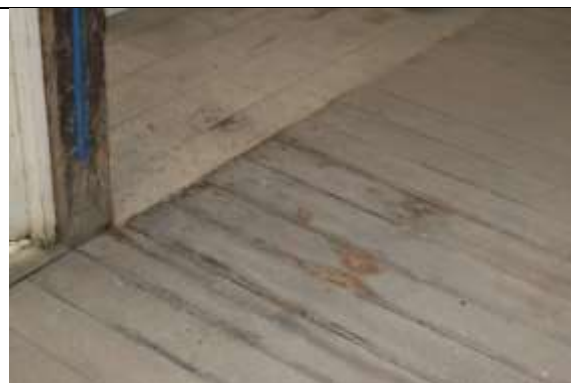
Figura 34 – Danos no piso.
