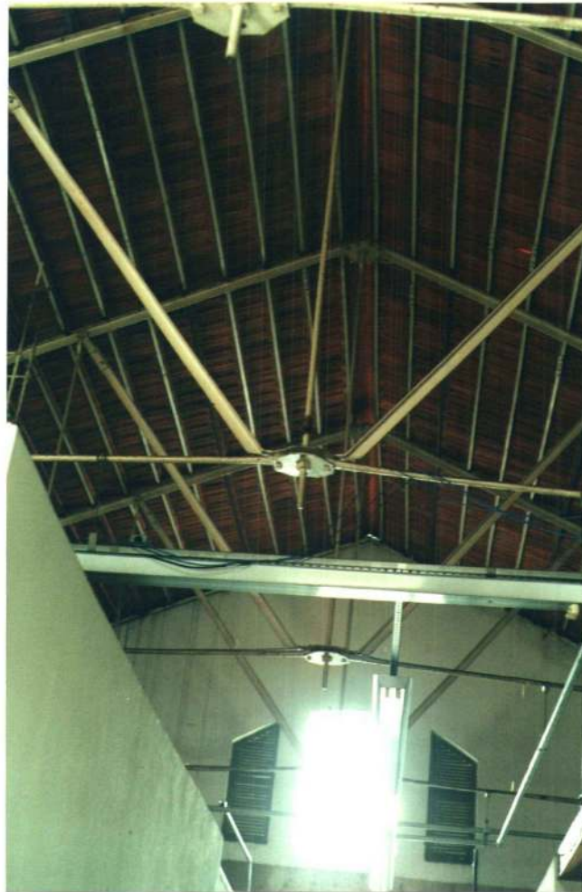
Gasômetro do Brás: Casa de Medidores – dois aspectos internos. Foto: STCR/ Condephaat Arqto. Sergio De Simone
